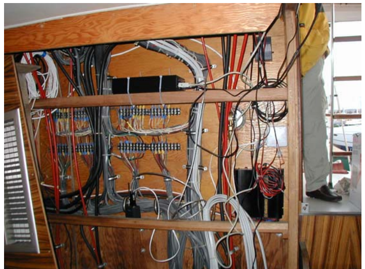
MY Mrvica, Zadar, Brodski PC ugrađen u panel sa brodskim instalacijama
